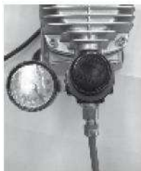
Obr. 6. Připojení kompresoru AS-18-2 a AS-19-2 k aerační koloně
